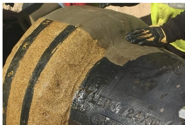
Vyplnění míst okolo příruby tmelem Longwrap LD Mastic před překrytím petrolátovou bandáží Longwrap.
