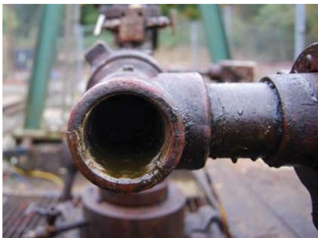
Toto potrubí bylo zcela ucpané, manometr neukazoval žádný tlak. Po aplikaci PRA byly během několika minut všechny parafínové nánosy odstraněny a potrubí vykazovalo normální tlak.
